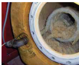
Zustand vor der Entkalkung.
